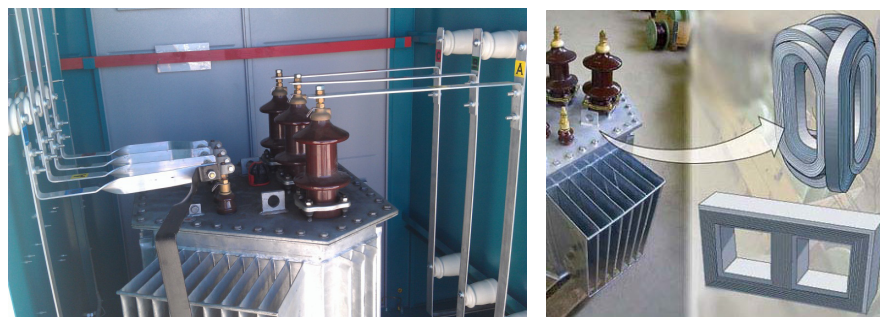
Рис. 6. Силовой трансформатор 10/0,4кВ с витым (тороидальным) сердечником. Опытная эксплуатация в ОАО «МРСК Центра»
